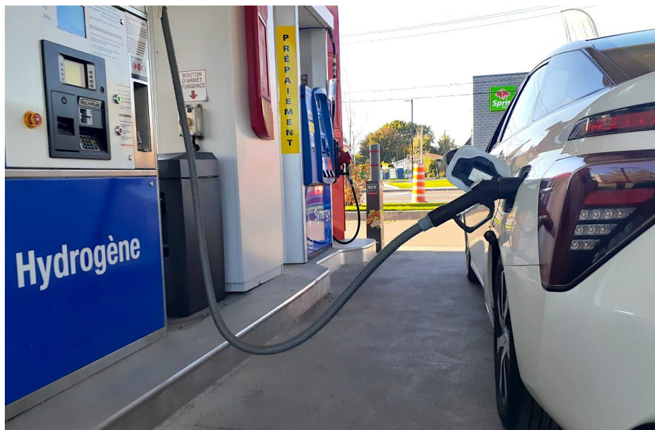
La station de ravitaillement à hydrogène d'Harnois Énergies en opération à Québec. L'hydrogène y est produit sur le site à partir d'un électrolyseur (Accelera/Cummins).
